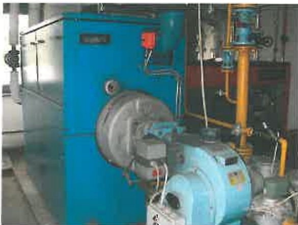
Földszint – kazánház, gázkazán
