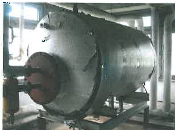
Földszint – kazánház, forróvítartó
